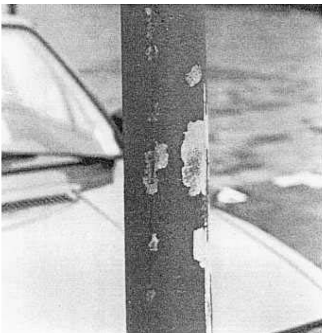
38 Bild 1. feuerverzinkter Stahlrohrmast
