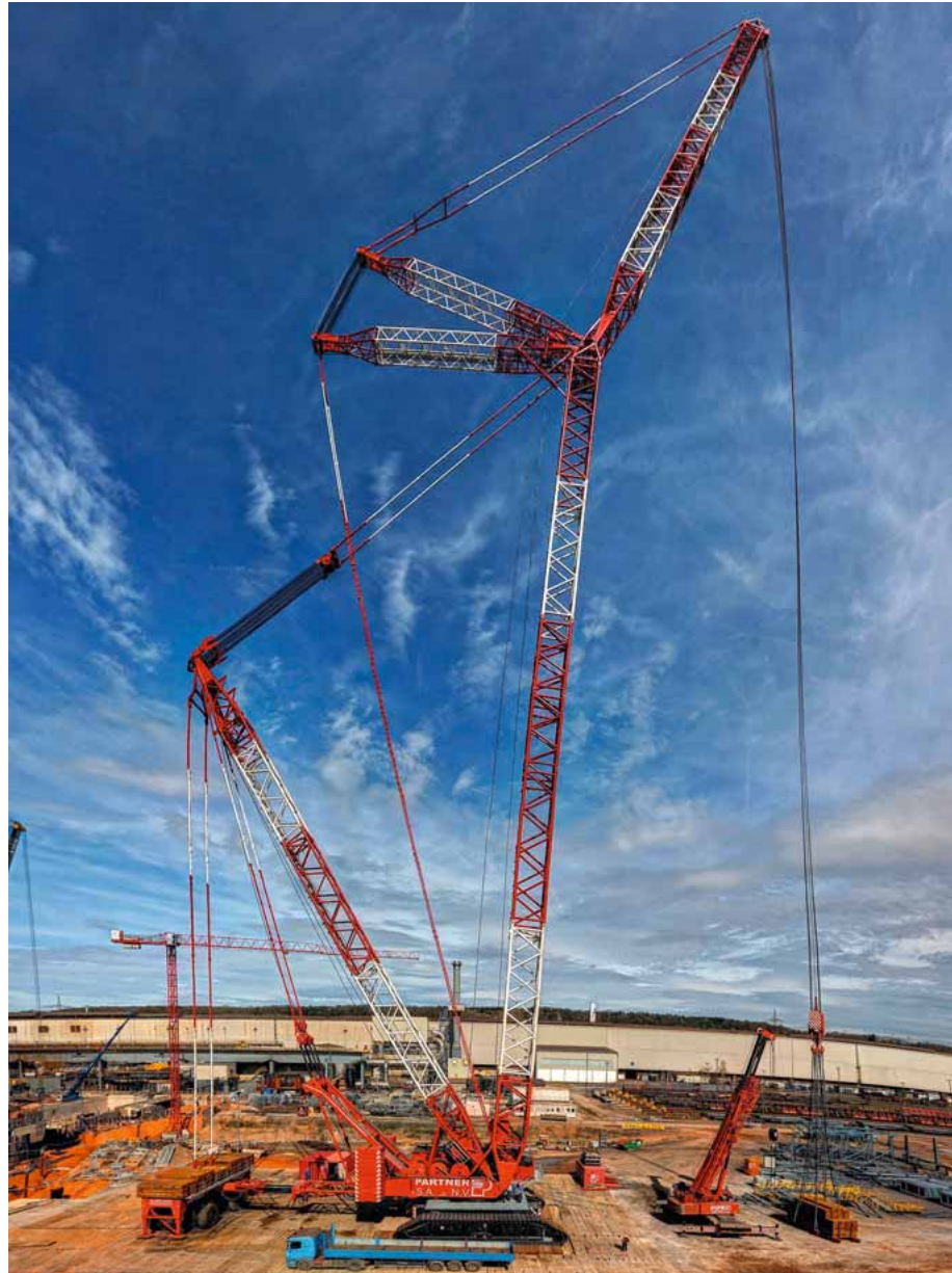
Bausstelle der Superlative: Die neue Stranggießanlage CC 6 ist mit über 300 Millionen € die größte Einzelinvestition am Standort Dillingen
