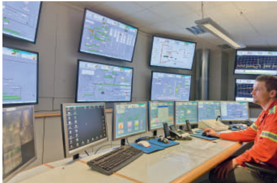
Kontinuierliche Investitionen in Anlagen und Prozesse auch bei der ROGESA: Blick in die neue Messwarte
